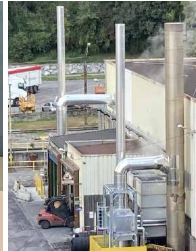
Récupération de la chaleur fatale des fours de recuits (RC8) dans l'atelier Parachèvement Fil Machine
